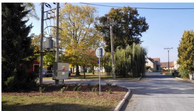
okolo transformátoru byly vysazeny poléhavé růže
