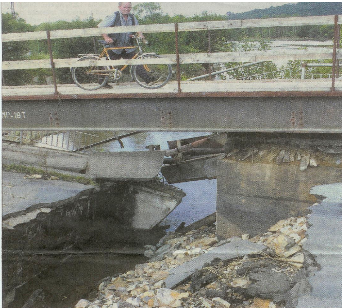
Povodeň v západních Čechách poničila několik silničních mostů, zcela strhla tento v Sedlci u Starého Plzece. Včera už tam mohli chodit alespoň pěší po provizorní lávce. Foto J. Vogeltanz
